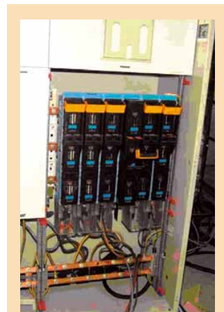
1 Kabelklemmen – scheinbar mit vollständigem Schutz gegen zufälliges Berühren
