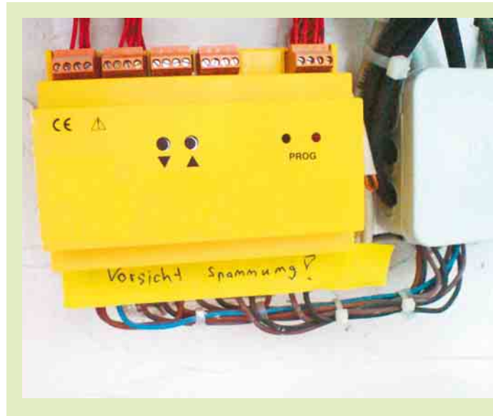
1 Unzulässige Montageart für ein Reiheneinbaugerät bei Betrieb mit AC 230 V
