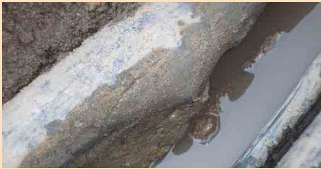
③ Schadensstelle vor Trennung des Kabels
