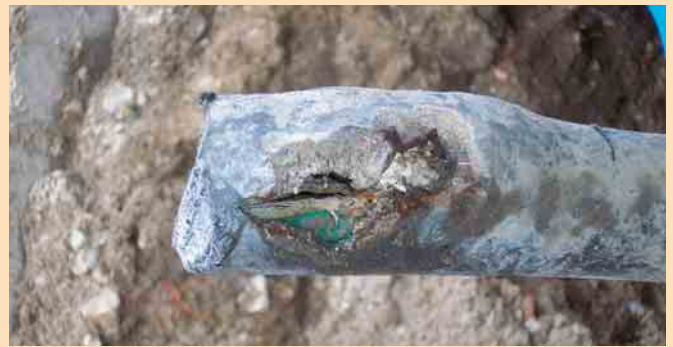
④ Schadensstelle im Kabel nach Trennung des Kabels
