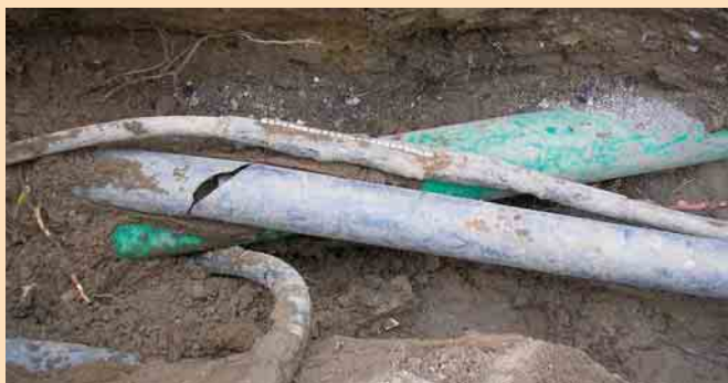
1 „Wilde Kabelverlegung“ auf dem Verfüllboden über den Abwasser- und Regenleitungsrohren
