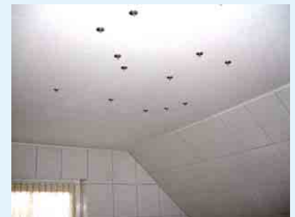
1 a In der Luftdichtefolie befinden sich Undichtigkeiten, wodurch auch kalte Luft über die Halogenstrahler ins Bad eindringt
