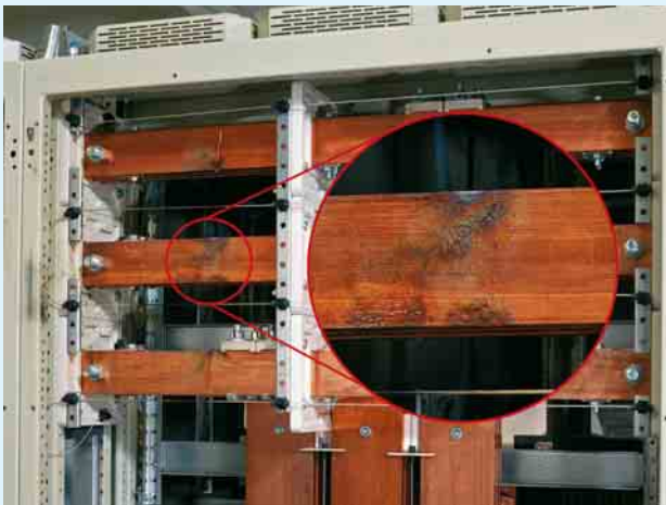
13 Schadensbild – 440 V, 100 kA unbeeinflusster Kurzschlussstrom mit Löschung durch Löscherät
