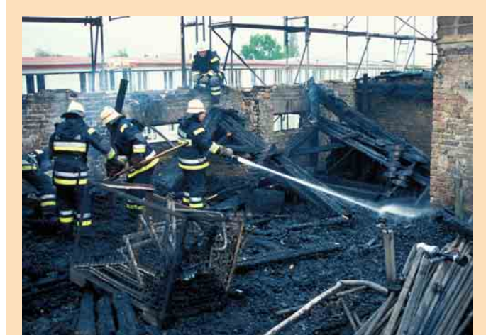
7 Bei einer geplanten Dachgeschossaufstockung geriet das alte Dachgeschoss durch Bauarbeiten in Brand.
