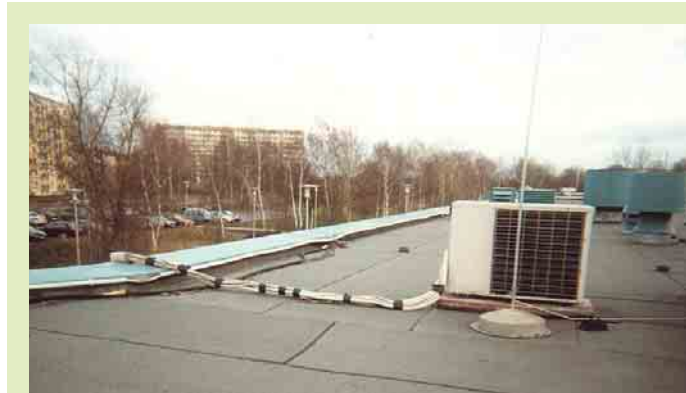
1 Teil der Klimaanlage direkt neben der Fangstange auf dem Schwimmbad-Dach
