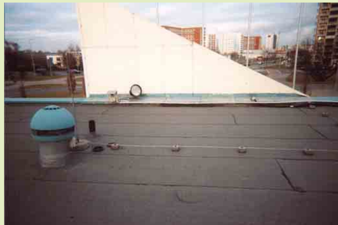
2 Blitzschutzleitungen parallel zur Attika und über Stecker angeschlossen Flutlichtscheinwerfer
