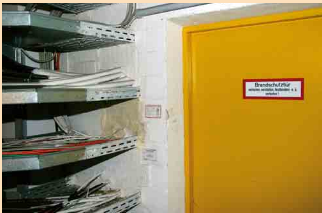
② Fachgerechte Schottung von Leitungsanlagen braucht Platz – Nachlässigkeit bei der Planung steigert die Kosten erheblich
