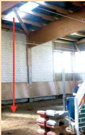
❶ Der ungesicherte Monteur brach durch das Dach und fiel 6 m tief
