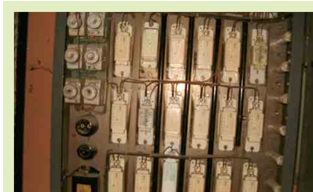
1 NS-Verteilung einer Treppenhausbeleuchtung, bei der ein notwendiger Berührungsschutz fehlt
