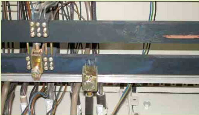
❶ Korrodierte Kupfer-Sammelschiene
