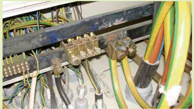
❷ Korrosion an der MSR-Anlage in einem Schaltschrank
