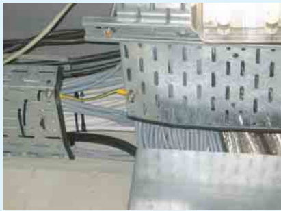
❶ Unzureichende Verbindung an den Stoßstellen von Leitungsführungssystemen
