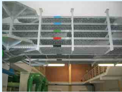
❷ Vorbildliches System mit getrennter Verlegung der Kabel und Leitungen für die Energieversorgung und informationstechnischen Systeme
