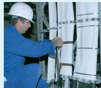
1 Kabelvollbandage an einer Steigetrasse zur Verhinderung der Brandausbreitung entlang der Kabeltrasse
