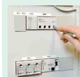
1 Einbindung der Beleuchtungs- und Jalousiesteuerung, der Störungsmeldungen, der Beschattung sowie der Wetterstation über KNX/EIB
