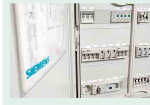
3 Blick in die Verteilung mit Leitungs- und FI-Schutzschaltern sowie Sicherungstrennschaltern und Spannungsüberwachung
