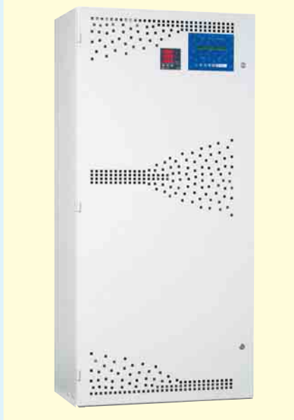
➊ Stromquelle für Sicherheitszwecke mit einer Leistung von 3 kVA
