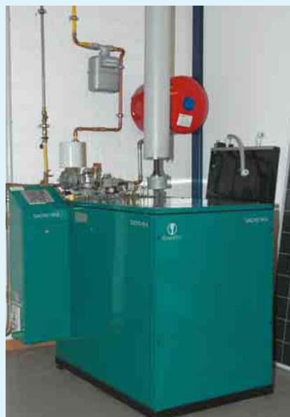
④ Erdgas-BHKW zur Beheizung einer Gewerbehalle
