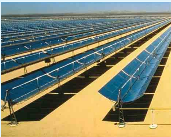
⑤ Parabolrinnen-Kollektor (Projekt Euro-trough) Foto: SEGS
