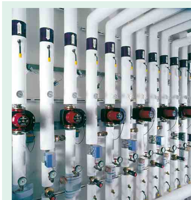
1 Heizsumwälzpumpen mit integriertem LON-Busmodul in einem Heizverteiler
