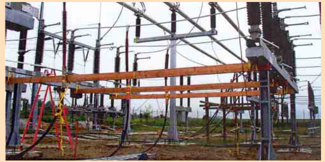
❶ Holzbalken, auf denen sich der Verletzte den 110-kV-Trennern näherte
