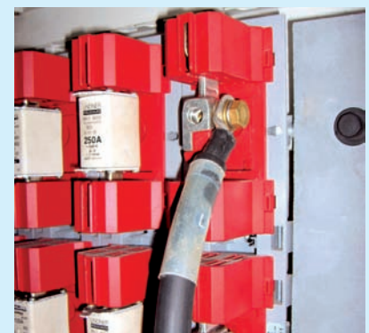
3 Einspeisung über NH-Kurzschließeinsätze
