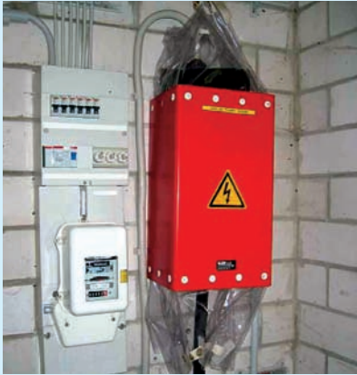
⑥ Der Hausanschlusskasten muss durch eine Isolierende Abdeckung wieder gegen Berühren geschützt werden Fotos: Korth
