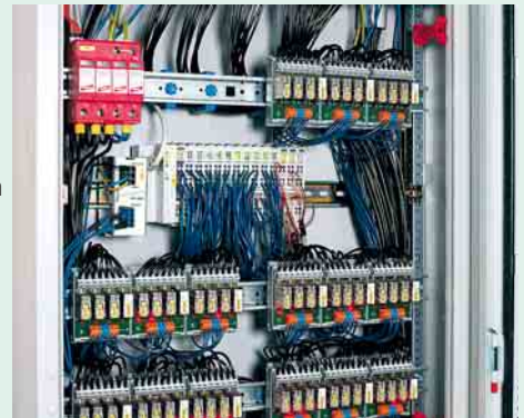
③ Herz der Steuerung: Wago-Feldbusknoten mit Ethernet-Controller (Bildmitte) umgeben von schienenmontierbaren Relais-Bausteinen
