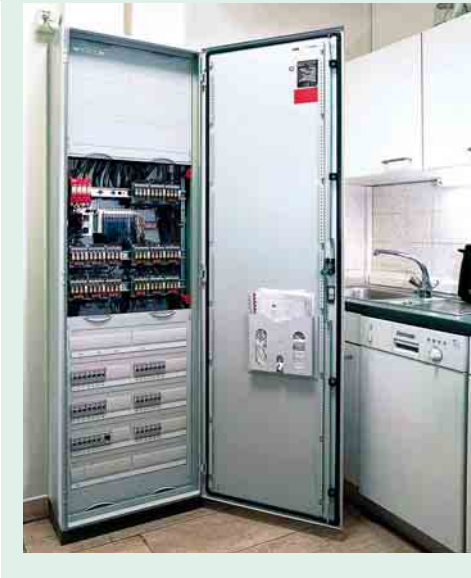
4 Schmäler Schaltschrank in der Teeküche als Etagenverteiler
