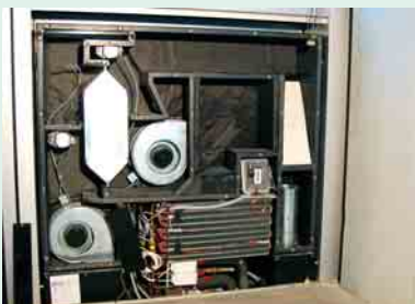
2 Die Lüftungsgeräte wurden speziell für den Einsatz entworfen und in die Fassade des Gebäudes integriert
