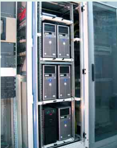
3 Blick in einen Netzwerkschrank: Hier stehen die Gebäudeleittechnik-Rechner. Das Gebäudemanagementsystem sorgt dafür, dass alle Informationen der 24 000 Datenpunkte jederzeit verfügbar sind.
