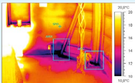
1 Thermografische Aufnahme von Luftundichtigkeiten im Dachgeschoss
