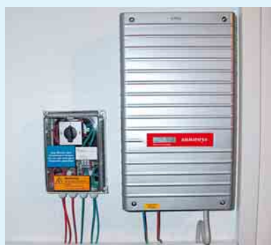
① Separater DC-Lastschalter vor dem Wechselrichter Foto: MHH Solartechnik
