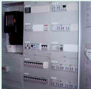
2 Funktionsmodule sind im rechten Verteilerfeld installiert. Reserveleitungen und Raum für Erweiterungen wurden vorgesehen.
