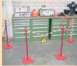
⑥ Zeitweiliger, operativ zusammengestellter Prüfplatz nach DIN VDE 0104 außerhalb der Elektrowerkstatt
