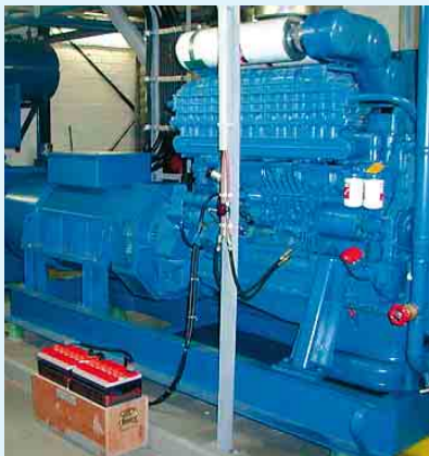
② Dieselaggregat als SV-Stromquelle im Einsatz [9]
