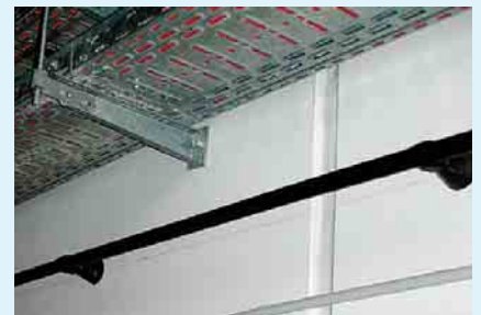
2 Schlitzbandkabel in einer Gebäudefunkanlage Quelle: Berufsfeuerwehr Erfurt, Sachgebiet Kommunikation
