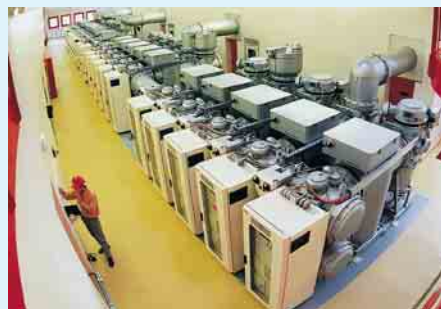
③ Gasisolierte Schaltanlage
