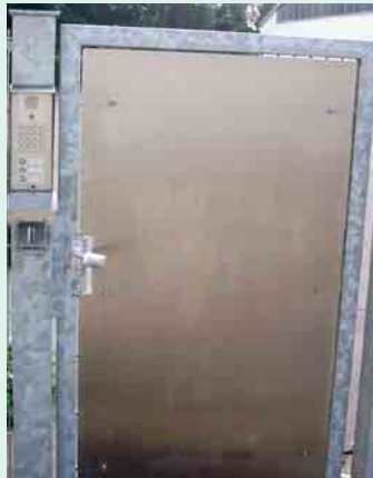
③ c für die Zutrittskontrolle zum Betriebsgelände
