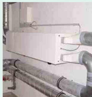
❷ Dezentrale Anlage zur Wärmerückgewinnung
