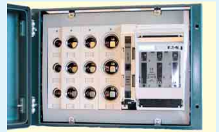
3 NS-Sicherungsverteiler in gemischter Bestückung auf Sammelschiensystemen
