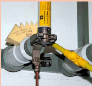
5 Feuchtreinigen von Schaltanlagen
