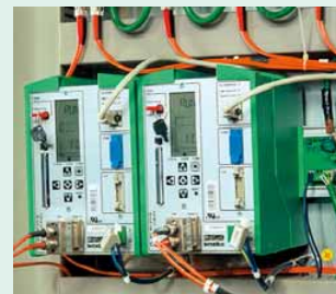
2 Remote Field Controller als Steuerung
