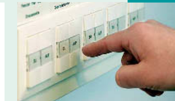
1 Zentralsteuerung im Hausmeisterzimmer
