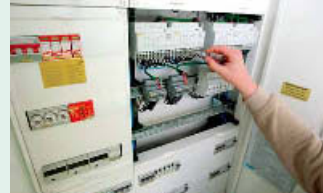
3 Aktorik des Bussystems im Alpha-Verteilerschrank
