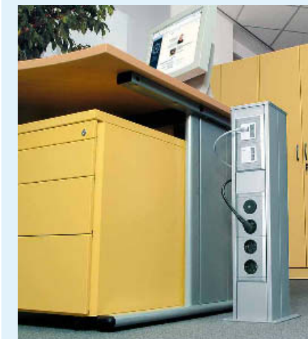
8 Tischhohe Installationssäule in einem Büro mit Steckdosen und Datenanschlüssen
