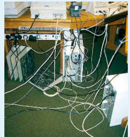
1 Stolpergefahren durch frei liegende Leitungen
