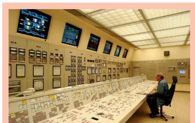
1 Leitwarte des Kernkraftwerks Obrigheim, das im Mai 2005 nach 37 Betriebsjahren vom Netz ging
