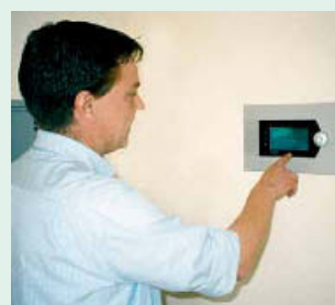
2 Bauherr Stefan Wulforth am Bedienpanel
