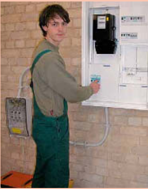
② Offizielle Inbetriebnahme der Elektroanlage
