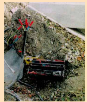
1 Unfallort – Kabel unter Spannung, dessen Adern der Monteur ohne Isolierhandschuhe zurechtbiegen wollte
