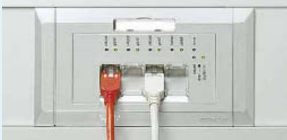
⑪ Switch mit 4-Ports für Endgeräte
