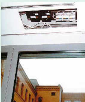
❷ Die Aktoren wurden platz sparend in der Zwischendecke über den zugehörigen Fenstern installiert
