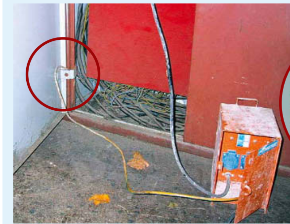
3 Fehlerhafter Anschluss eines Kleinbaustromverteilers
