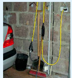
❷ Ortsveränderliche Fehlerstrom-Schutzeinrichtung (PRCD-S) als Speisepunkt einer kleinen Baustelle
