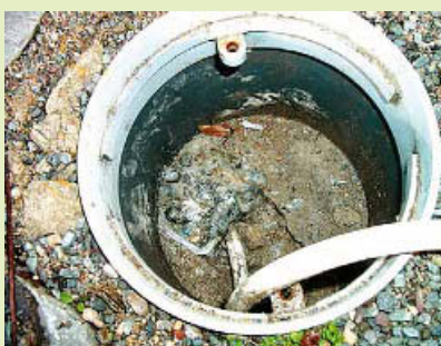
❹ Nach unten offenes Rohr zur Installation der Fahrbahnbeleuchtung
