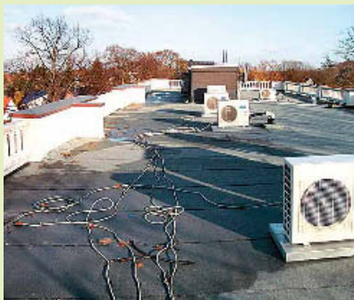
❶ Lose auf dem Teerpappdach verlegte Leitungen
