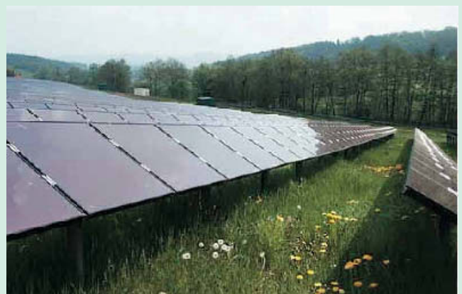
1 Sieben Teilanlagen mit je 1 800 Solarmodulen gestatten einen jährlichen Energie-Ertrag von 600 000 kWh
