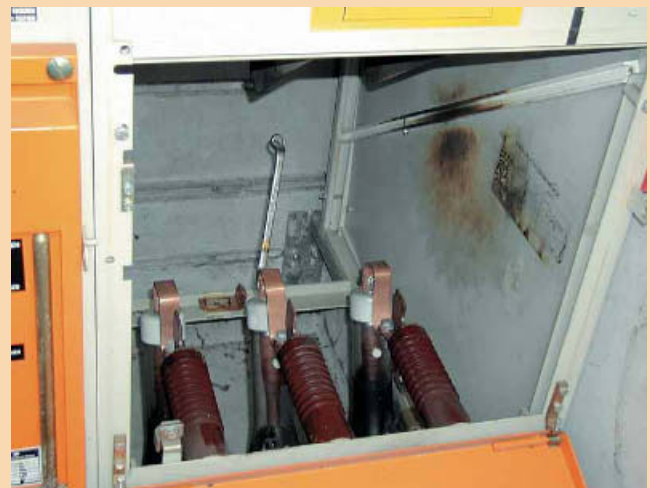
① Unfallstelle in der MS-Schaltzelle
