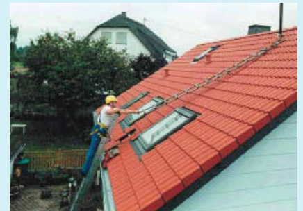
2 Einsatz einer Dachleiter bei gleichzeitiger Sicherung am Dachständer einer Freileitung
