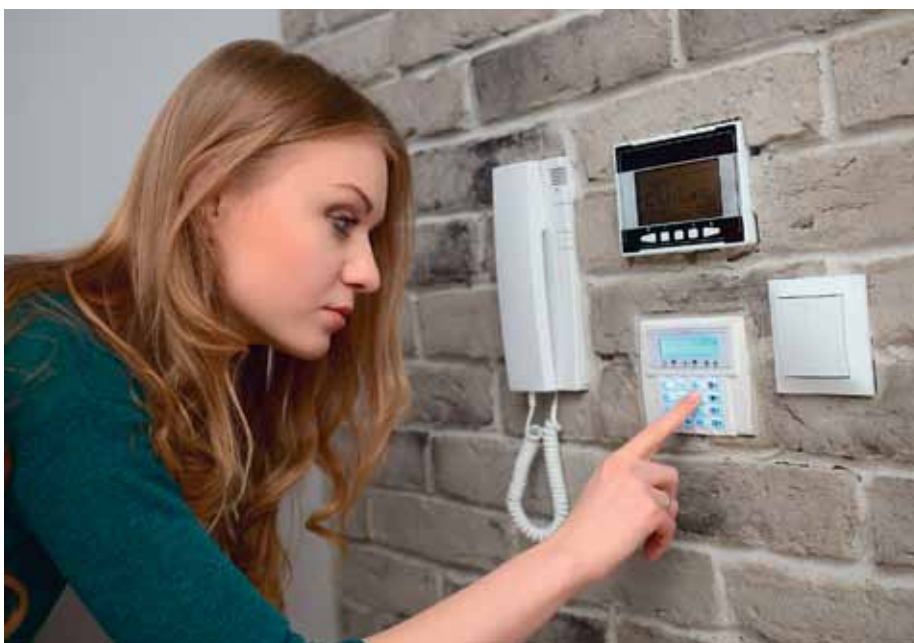
Aktivierung einer Gefahrenmeldeanlage
